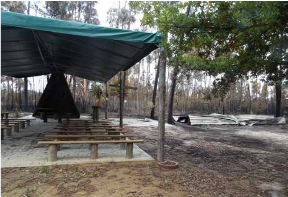
Centro Escutista parcialmente destruído pelo incêndio – Palco
